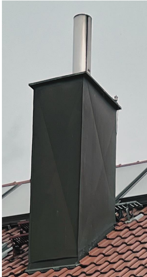
Abbildung 7: Aufbau elektrostatische Staubabscheider auf dem Dach (Quelle: Exodraft)
